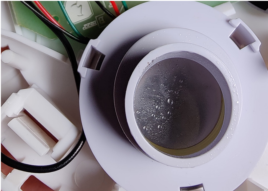
■ Kuva 13. Testikaasujen tiivistymää palovaroittimien rakenteiden sisällä.
