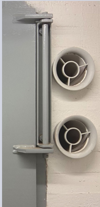
■ Ilmanohjaimet sijaitsevat esimerkiksi kellarikäytävällä.
