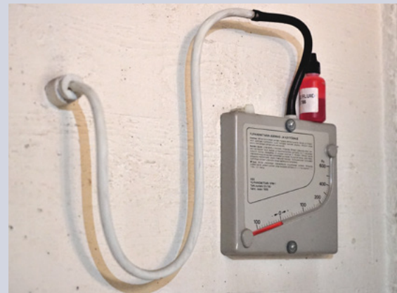
■ Ylipainemittari väestönsuojan sisällä.
